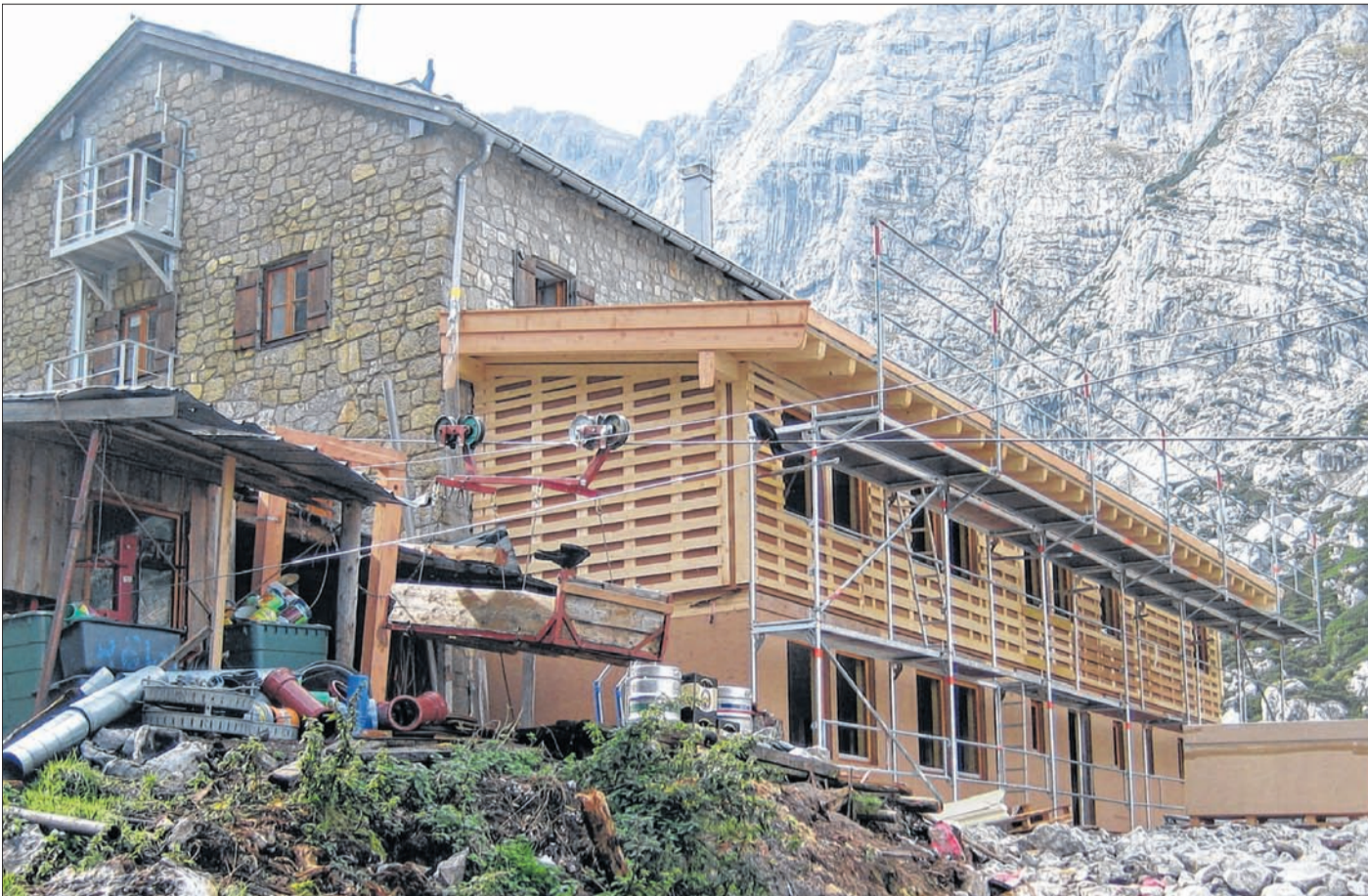
Der Anbau der Blaueshütte steht. In nur einem Tag wurden 13 Wandelemente, sechs Deckenteile sowie Sparren und Pfetten für den Dachstuhl angefliegen und aufgestellt.
