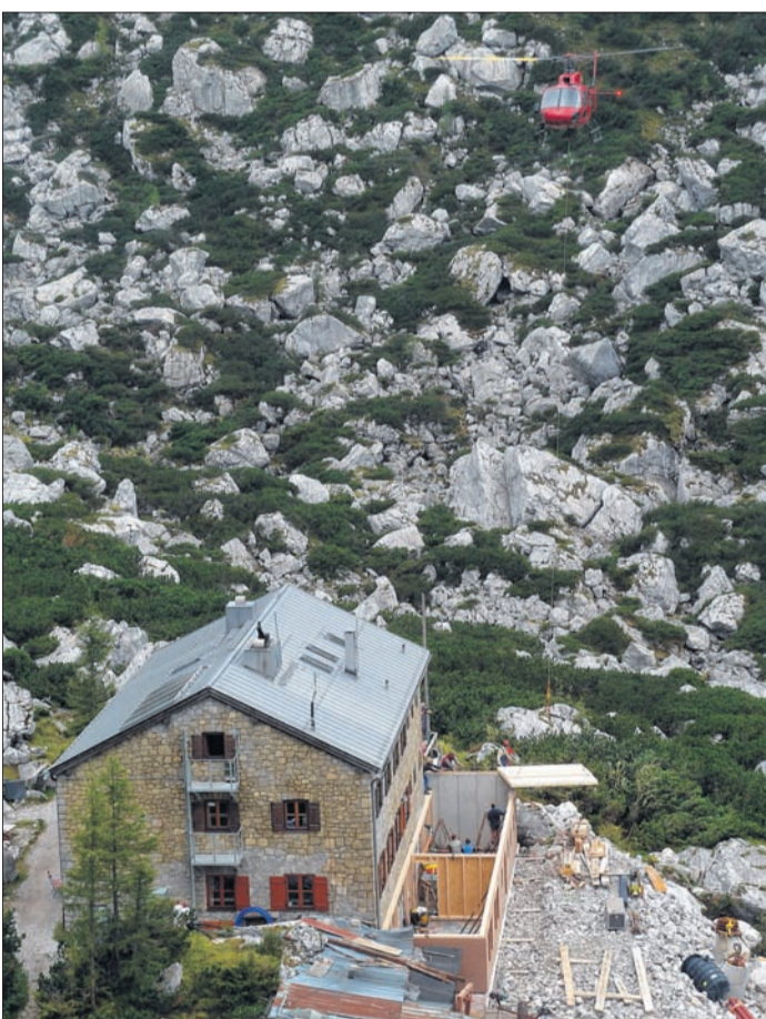
Millimeterarbeit aus der Luft: HTM-Hubschrauberpilot Georg Schuster manövriert punktgenau die Ladung an ihren Platz.
